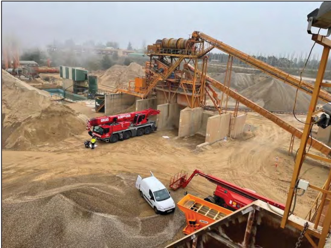
Vista parcial de las instalaciones de tratamiento.
